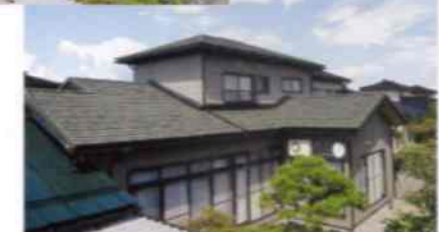
ディプロマット エバーグリーン (和瓦からの葺き替え工事)富山県
